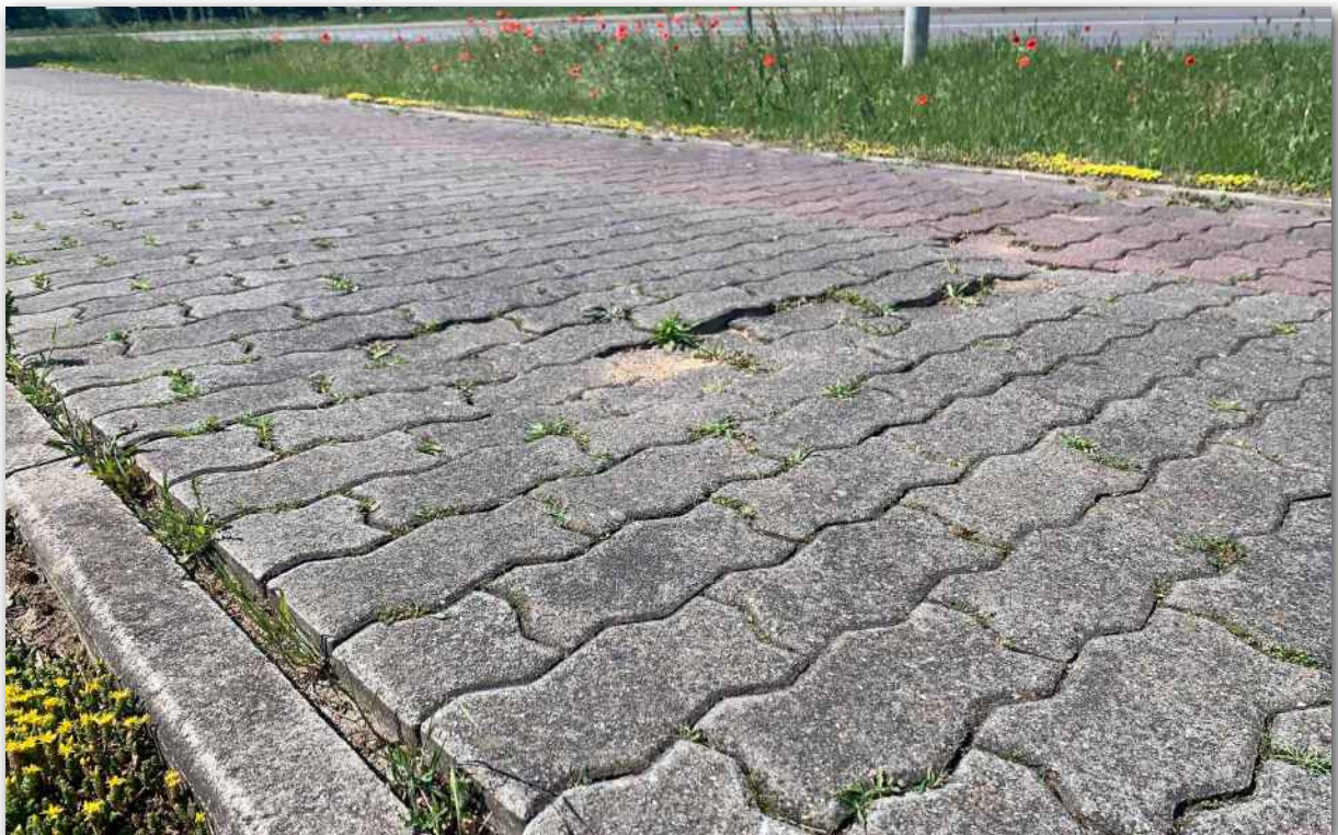
Abbildung 11 Gehweg mit Belagschaden, Kümmelsberg Westseite – Blickrichtung SW
