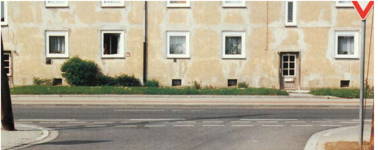
fehlende Bordabsenkung für Linksabbieger
