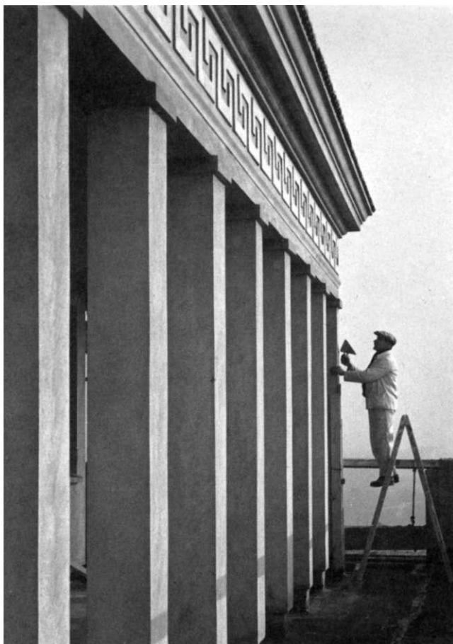
Bauten im Stil der 'Nationalen Tradition' am Zentralen Platz - ein Kalk, ein Stein...
