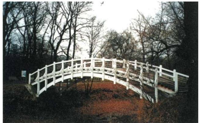
Sanierte Bogenbrücke zur Marieninsel im Stadtpark Rotehorn
