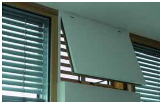
Abb. 29: Nachtlüftungsklappen Passivhausschule in Frankfurt /Main, 4a Architekten
