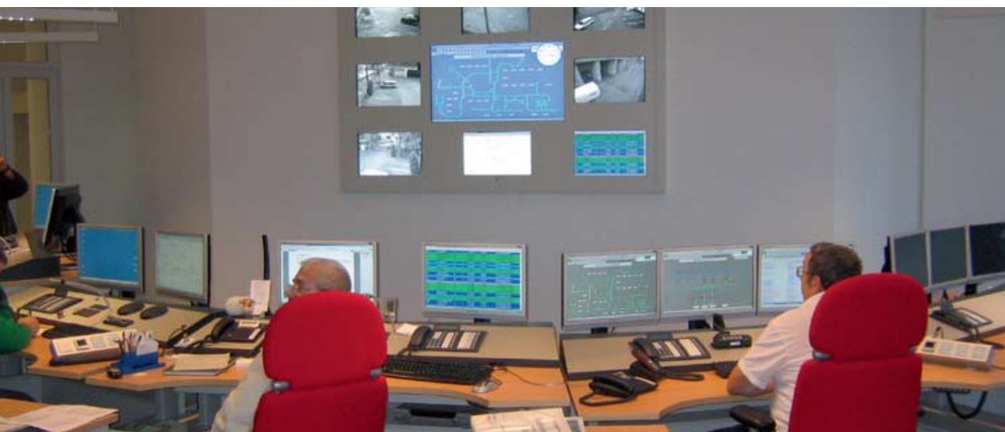
Betriebsleitzentrale der Magdeburger Verkehrsbetriebe GmbH
