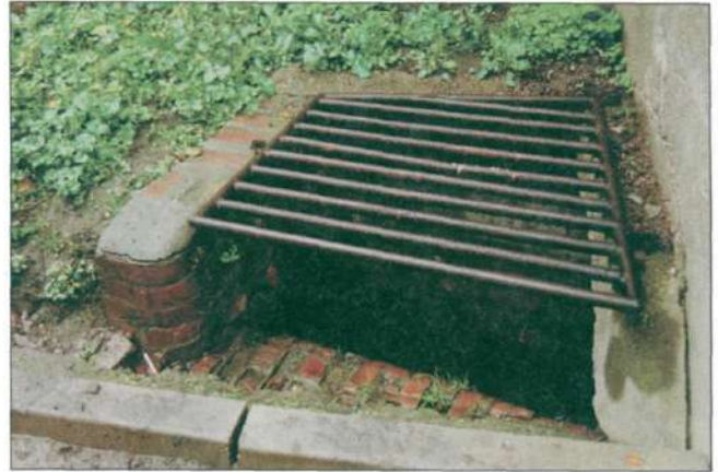
Negativbeispiel: Verrohrter Eulegraben am Dorfteich
