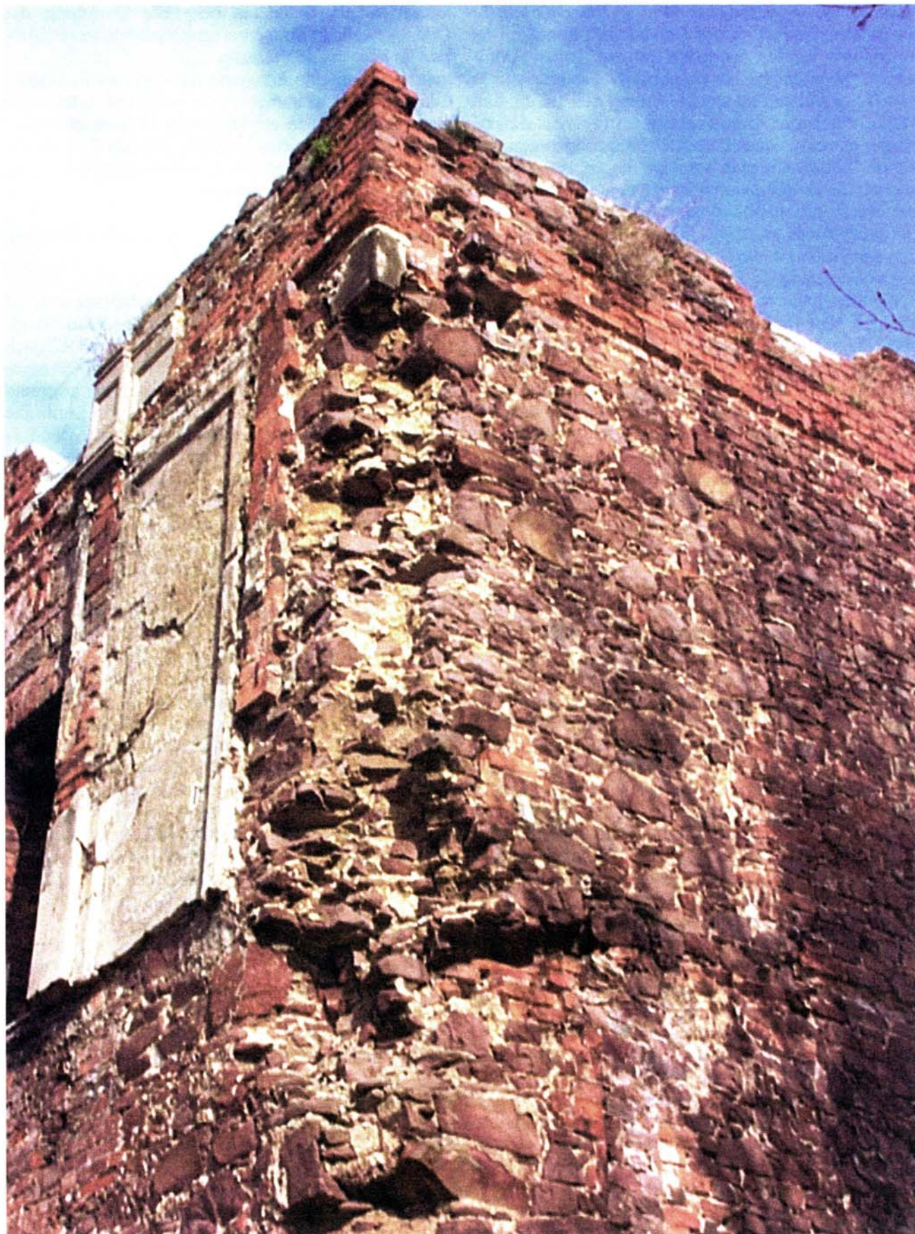
Turmuine, ausgebrochene Eckquaderung, auf der Wandfläche Putzreste aus der Überbauung im 19. Jh.
