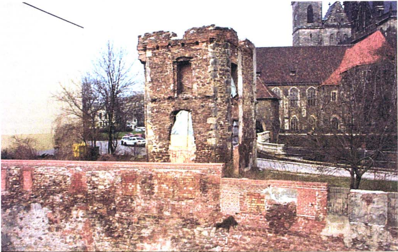
Turmuine, Ansicht von Osten, Ansicht mit Stadtmauer, starke Schädigungen im Mauerwerk
