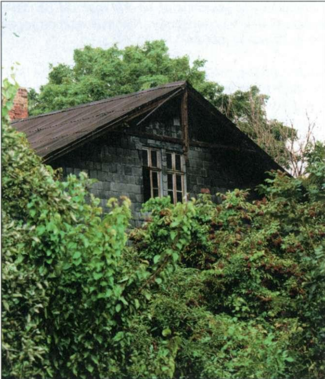
Abb. 38 Verschieferung des ganzen Gebäudes, Maybachstr. 3 (26), Stadfeld, Zustand 1994
