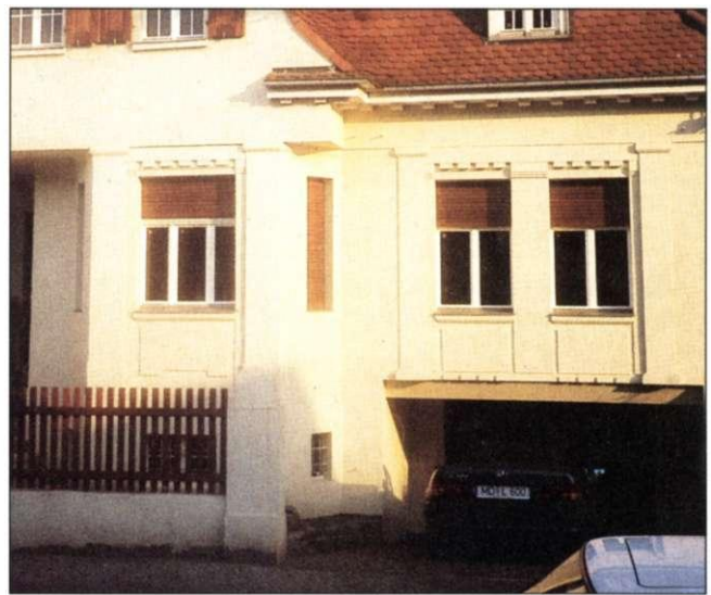
Eher gewaltsamer Eingriff: „Tiefgarage“ Rosenweg 4, 1995
