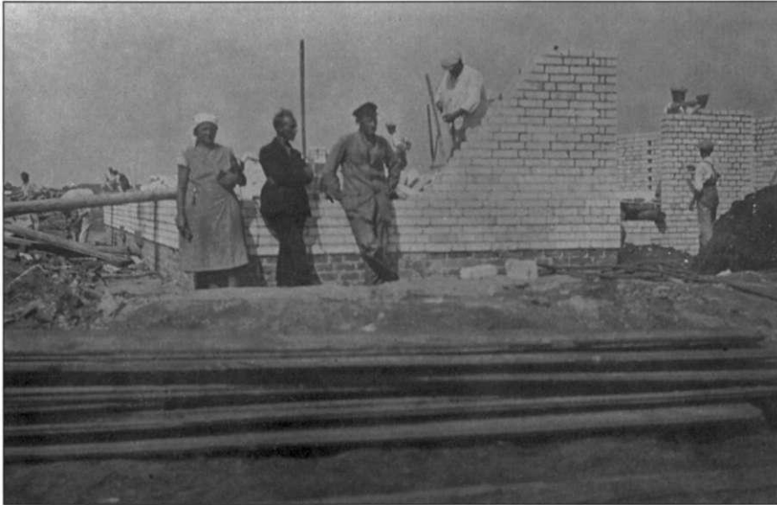
Bei den Maurerarbeiten leisteten die Siedlerfrauen Hilfsdienste. (Quelle: Archiv der Siedlergemeinschaft Lindenweiler)
