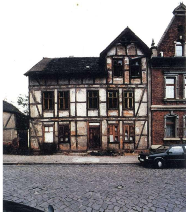
Verfallendes Gebäude in der Simonstr.
